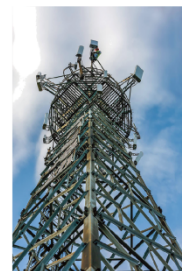
5G基站铁塔
